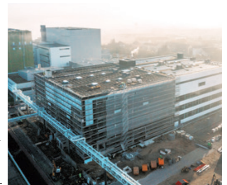
Zwei neue Gebäude für die Diagnostikproduktion von Roche. Foto: Roche Diagnostics GmbH
